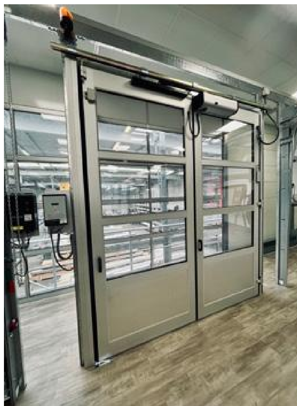
Aluminium Falttor 46 AF im hausinternen Schulungszentrum
